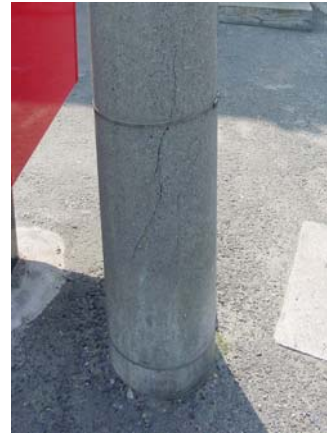
斜めひび割れ
