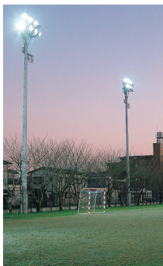
ロングポールを使用した照明設備
