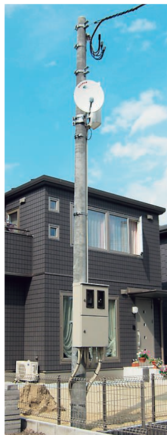
多目的引込ポール
