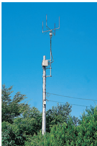
携帯電話用無線アンテナ柱
