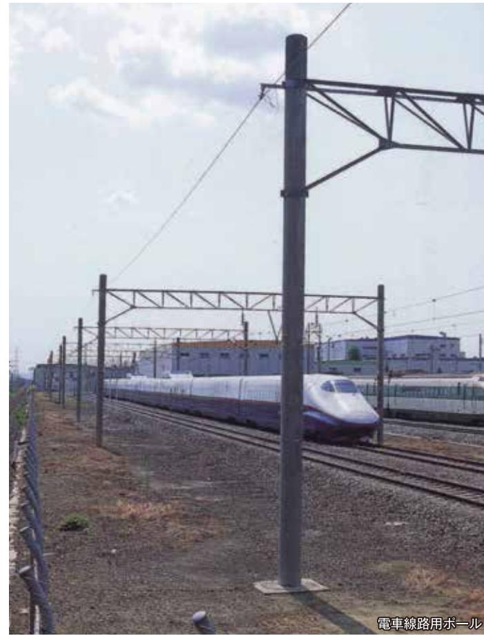
電車線路用ポール
