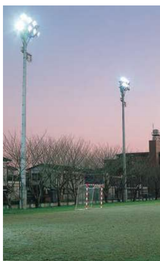
ロングポールを使用した照明設備
