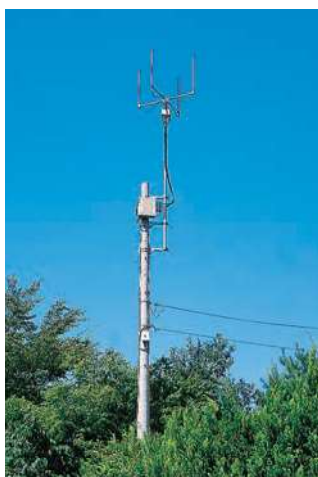
携帯電話用無線アンテナ柱
